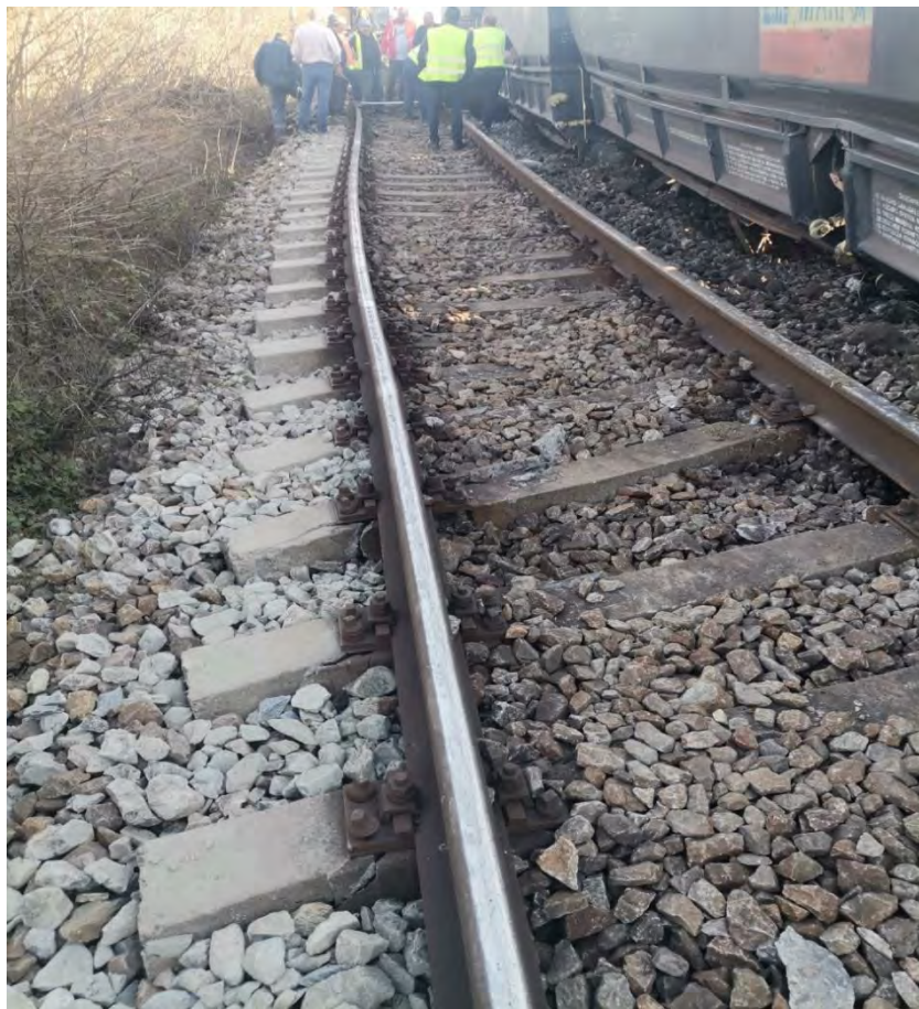
Foto nr.17 – deriparea liniei II directă, traverse din beton răsucite și strivite pe zona de rezemare
