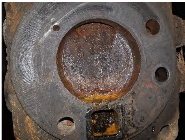
Foto nr.6 - impurități (rugină, praf de cărbune, apă) în sacul colector
