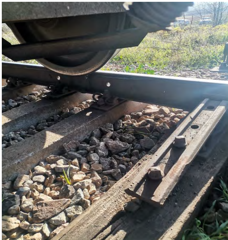
Foto nr.9 – urme de lovire pe flancul interior al ciupercii șinei la joanta sudată de la vârful schimbătorului de cale nr.1
