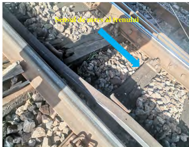
Foto nr. 14 – contrașina deformată a inimii de încrucișare a schimbătorului de cale nr.1
