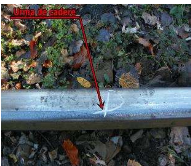
Foto nr.5: Punctul „D” - urmă de cădere în exteriorul căii (roata din partea dreaptă a osiei nr.5)
