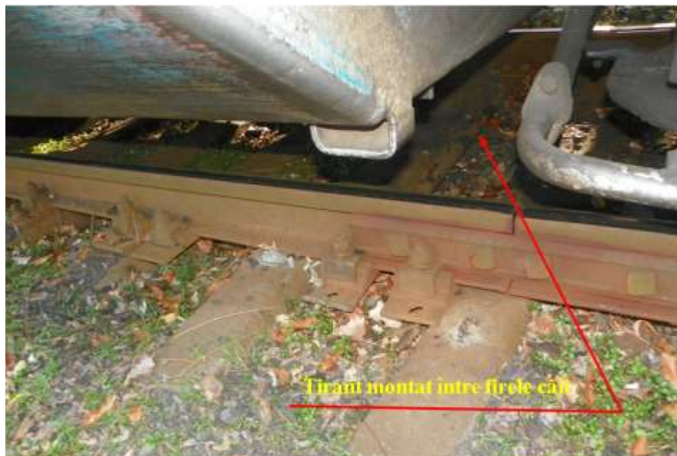
Foto.nr.7 - Tirant montat între firele căii
