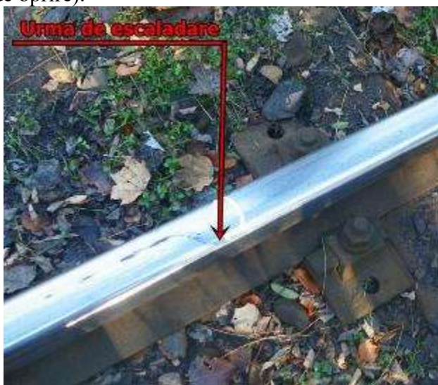
Foto nr.3: Punctul „0” - prima urmă de escaladare la km 19+608 (roata din partea dreaptă a osiei nr.6)
