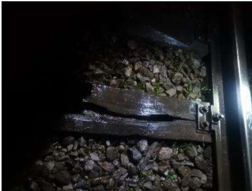
Foto nr. 12- Starea tehnică a traversei T-29
