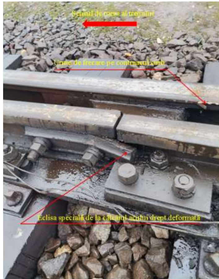
Foto nr. 9 Eclisa specială de la călcâiul acului drept deformată
