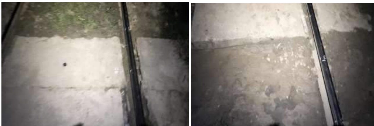
Imaginea nr. 12 – prisma de piatră spartă în zona trecerii la nivel cu calea ferată km 98+564
