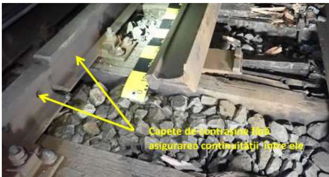
Foto nr.24 - Contrașină de pe terasament alcătuit din mai multe cupoane de șină, prin urmare, nu era asigurată continuitatea între acestea
