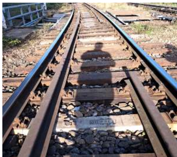
Foto nr.30 – lipsă continuitate la contrașină
