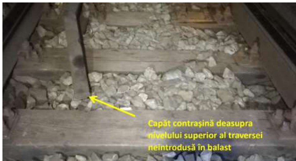
Foto nr.23 - Extremitate contrașină de pe terasament ne îndoită suficient în plan vertical în așa fel încât capătul să intre în balast sub nivelul traversei.
