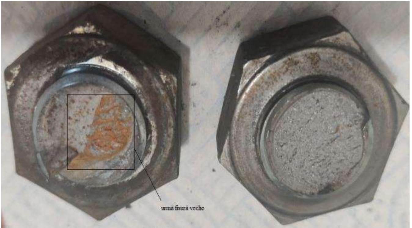
Foto nr.5 Urmă de fisură veche pe capătul șurubului forfecat
