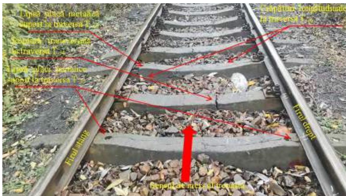
Foto nr.17: Starea tehnică a traverselor T 35 , T 34 și T 33
