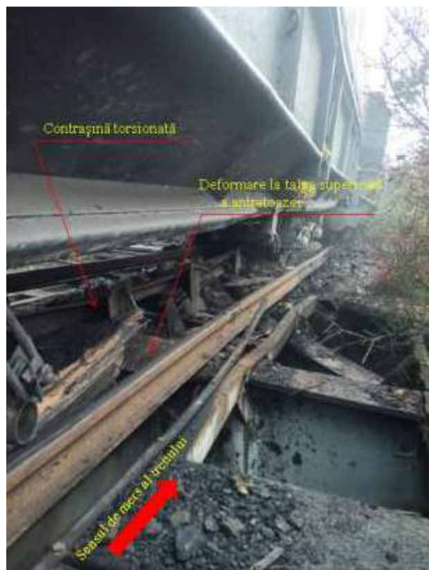
Foto nr.16: Deformare la talpa superioară a antretoazei
