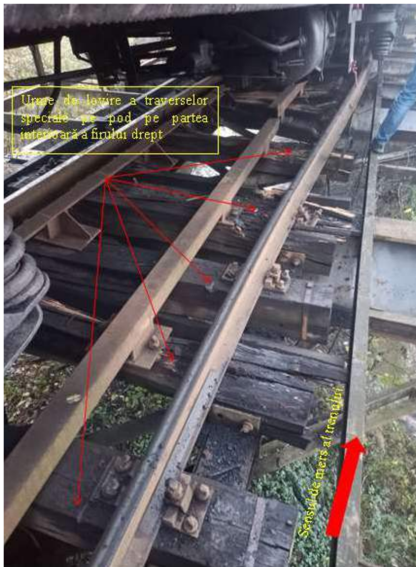
Foto nr.14: Urme de lovire a traverselor speciale de lemn pe pod
