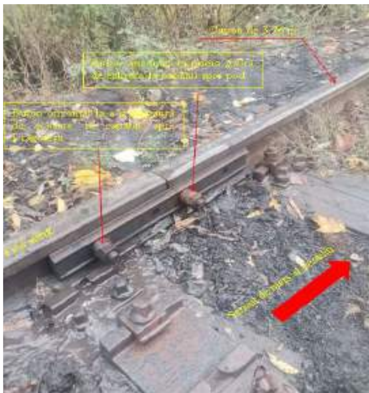
Foto nr.12: Întreruperea neconstructivă de la km 28+483,76, firul stâng
