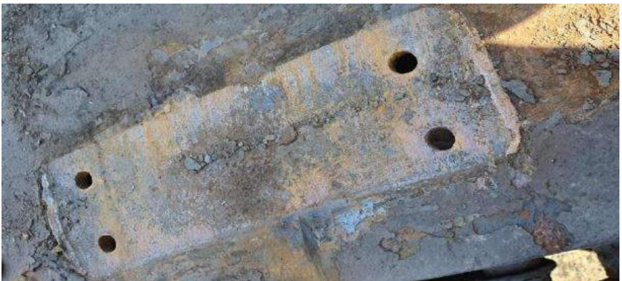
Foto nr.9: Urme proaspete de rugină pe cordoanele de sudură și pe cadrul boghiului pe suprafața de așezare a pietrei de frecare (9 zile de la producerea evenimentului până la efectuarea constatărilor)
