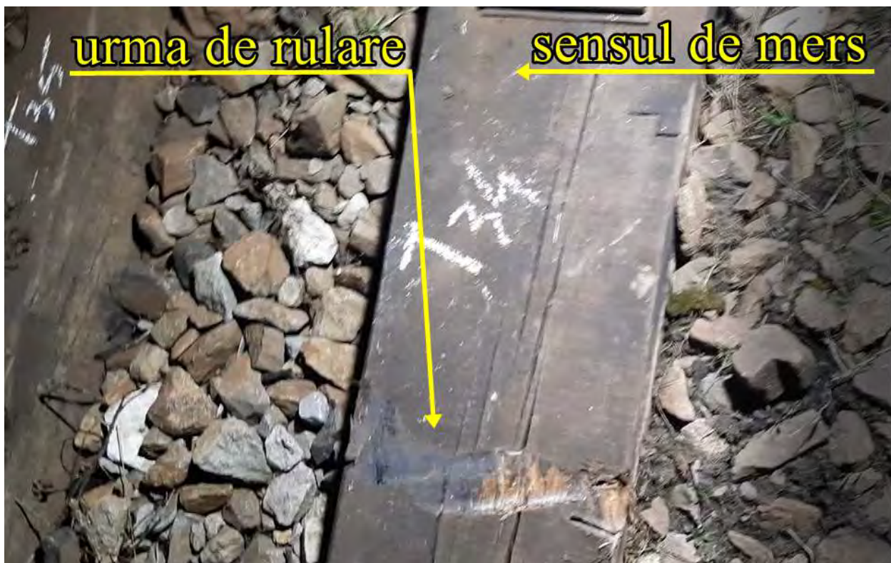
Foto. nr.31 – urma de rulare pe traversele de la motorul schimbătorului nr.21b
