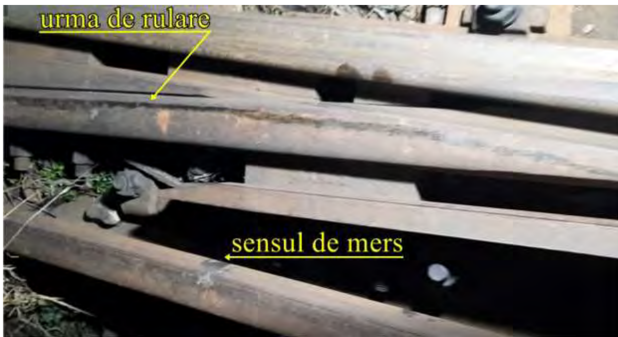
Foto. nr.20 – urma de rulare pe suprafața inimii duble de la călcâiul acului drept al schimbătorului nr.21b
