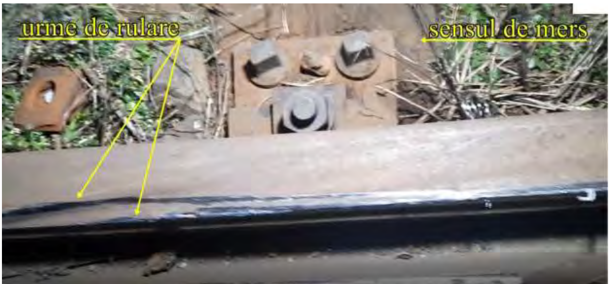
Foto. nr.22 – urma de rulare pe jgheabul dintre șina cot din dreapta vârfului inimii simple a schimbătorului nr.21
