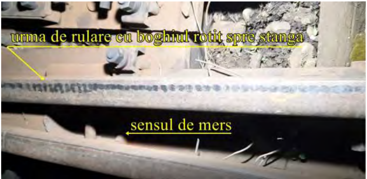
Foto. nr.21 – urma de rulare pe suprafața contraacului drept al schimbătorului nr.21b cu roata blocată din cauza rotirii forțate a boghiului
