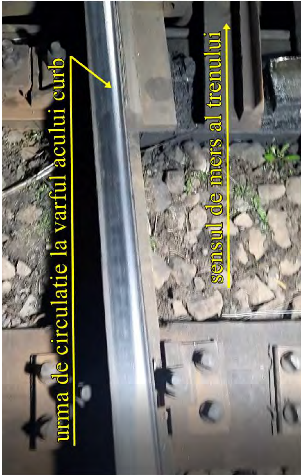
Foto. nr.11 – Urmă de circulație a roților atacante la vârful acului curb
