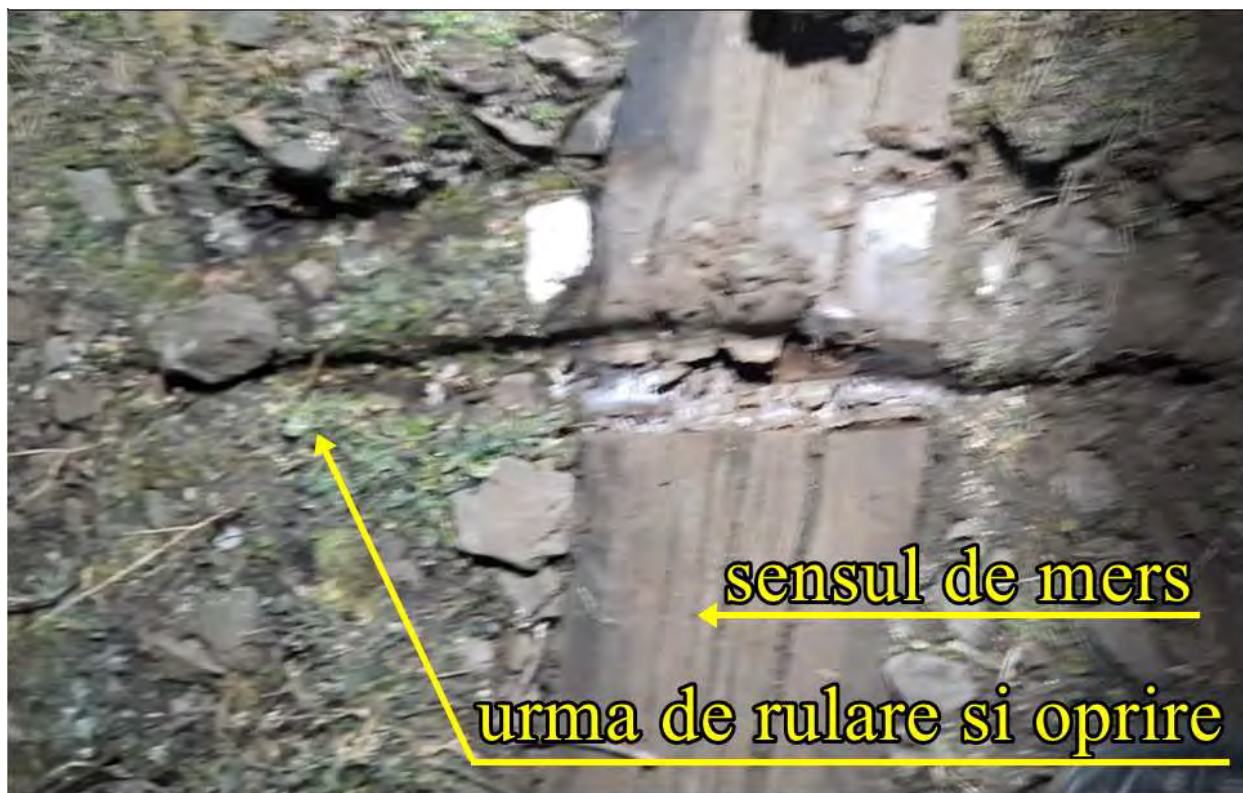
Foto. nr.32 – urma de rulare și oprire în dreptul vârfului inimii simple a schimbătorului nr.21b
