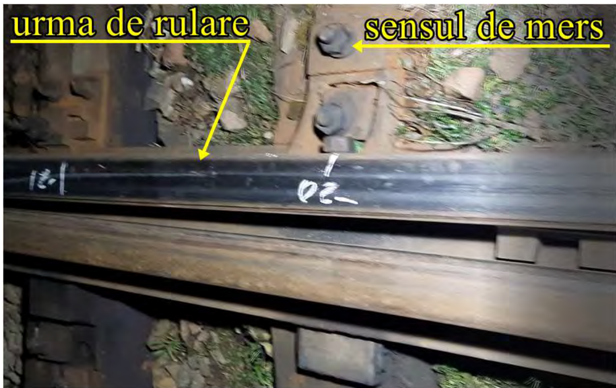
Foto. nr.27– urma de rulare pe contraacul curb a schimbătorului nr.21b
