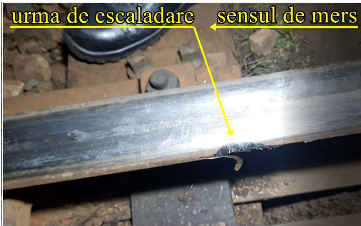
Foto. nr.24 – urma de escaladare a flancului activ al contraacului curb a schimbătorului nr.27a
