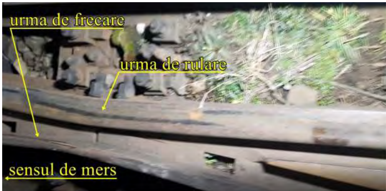
Foto. nr.19 – urma de rulare pe suprafața șinei cot a inimii duble de la călcâiul acului drept și de frecare pe profilul contrașinei
