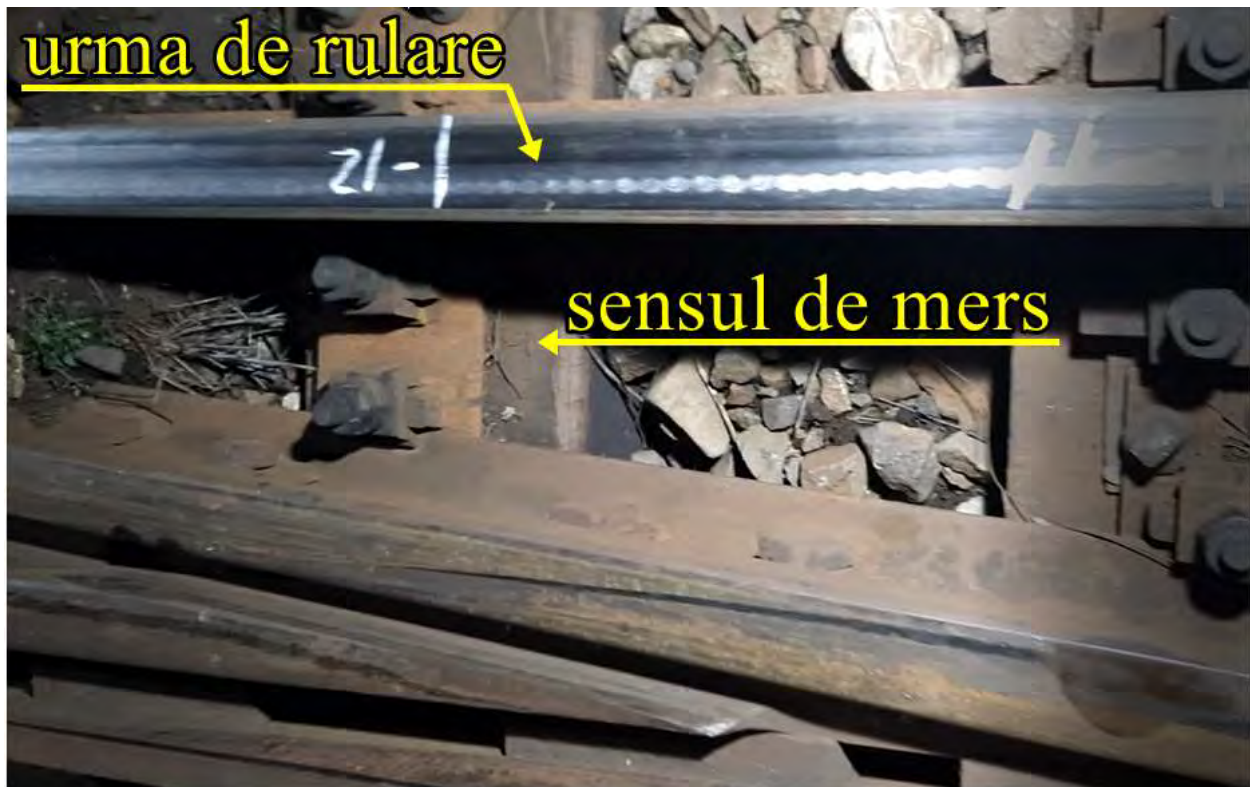
Foto. nr.26– urma de rulare pe șina de legătură dintre contraacele curbe ale schimbătorilor nr.27a și 21b
