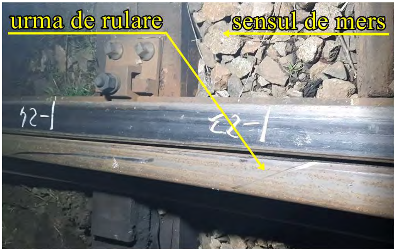
Foto. nr.28 – urma de escaladarea acului curb al schimbătorului nr.21b
