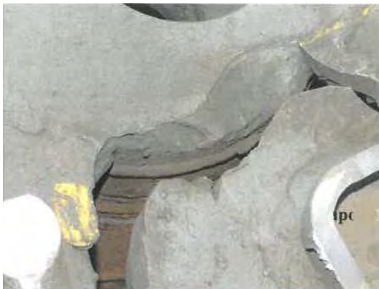
Foto nr. 7.-detaliu crăpătură în jurul suportului
