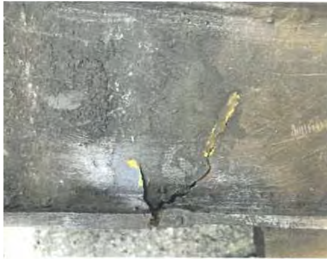
Foto nr. 5. -aspect crăpătură în latura dinspre suport 2. (vedere laterală)
