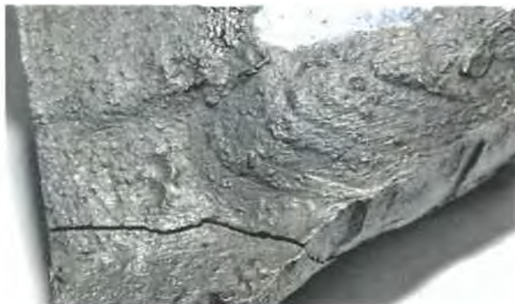
Foto nr. 12. -detaliu cu fisura propagată pe lângă cordonul de sudură (în ZIT)
