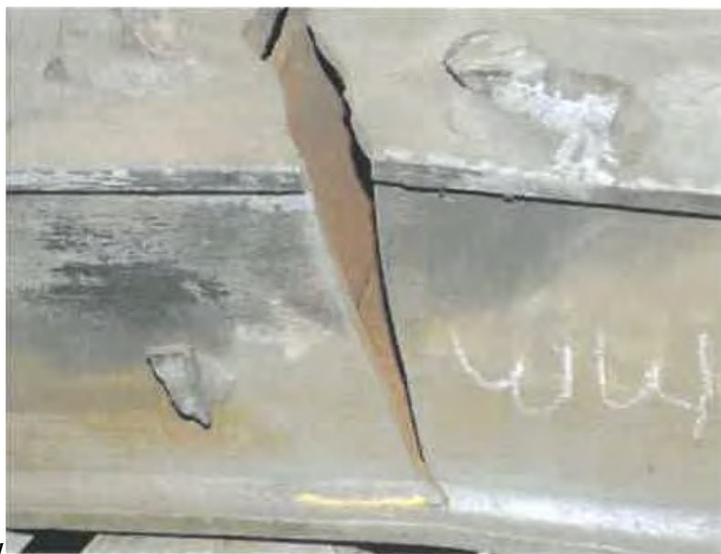
Foto nr. 8. -detaliu crăpătură în jurul suportului 1 (vedere laterală)
