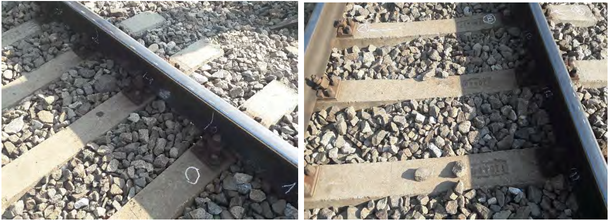
Foto NR. 17. - repere în legătură cu modul de producere a deraierii
