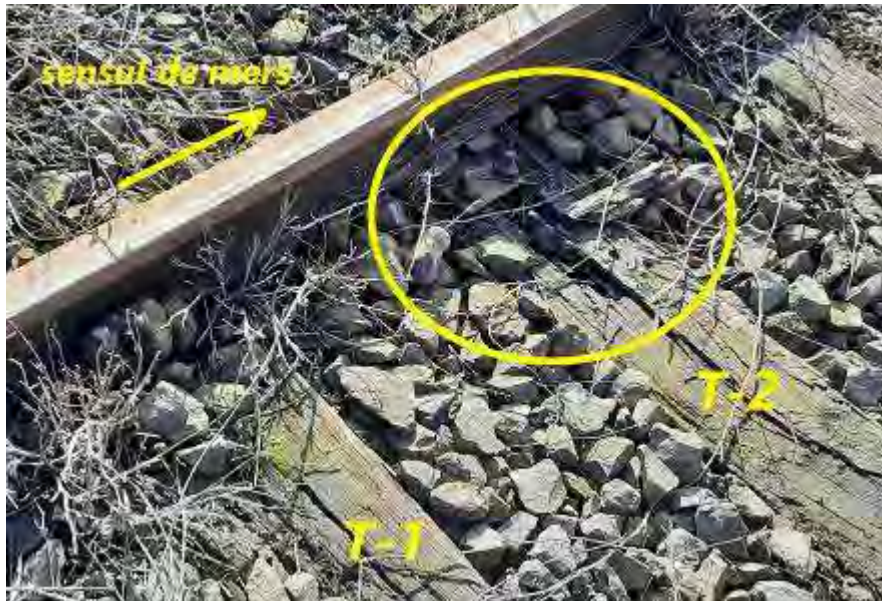
Foto nr.3 – traversele T -1 și T -2
