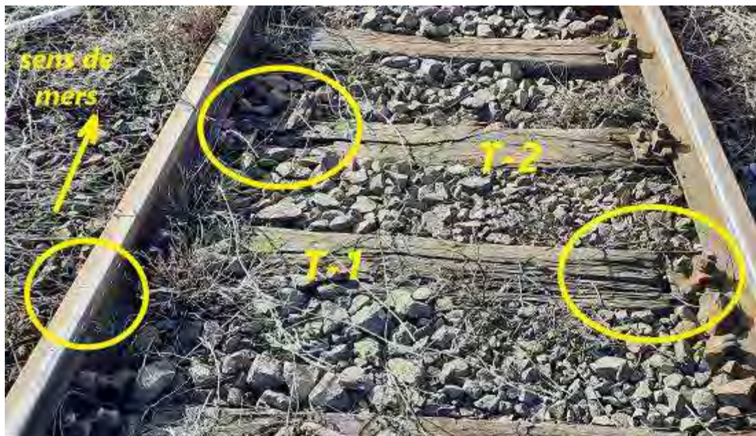
Foto nr.4 - traversele T -1 și T -2
