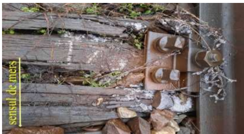
Foto. nr.8 - Traversa T1
