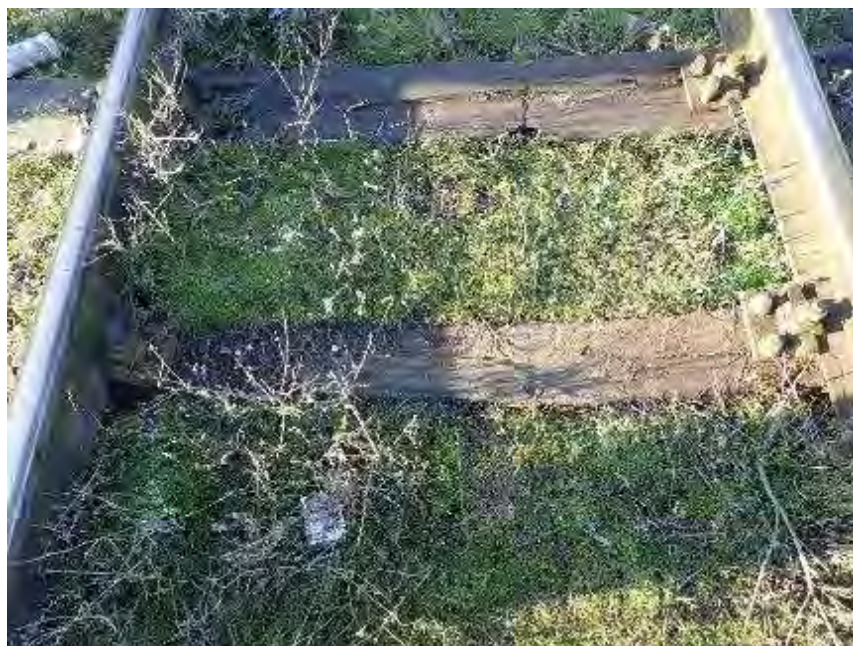
Foto nr.7 - traverse cu prinderi inactive, lipsă prismă de balast
