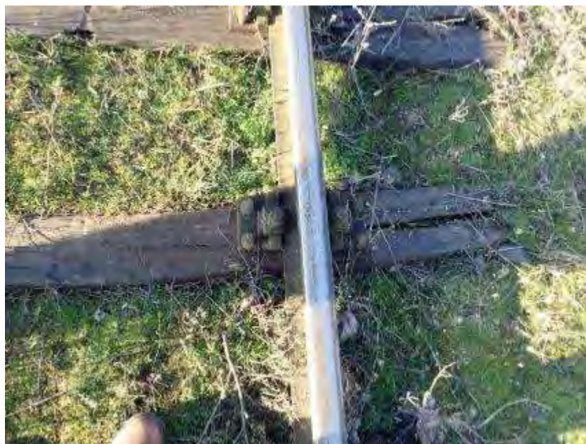
Foto nr.6 - traverse crăpate și putrede, lipsă prismă de balast
