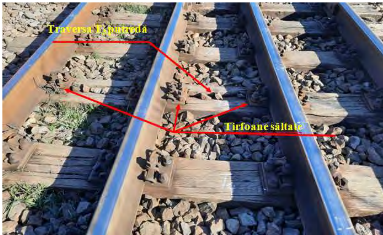
Foto. nr.20 – Traversa nr. 3 putredă cu prinderea inactivă
