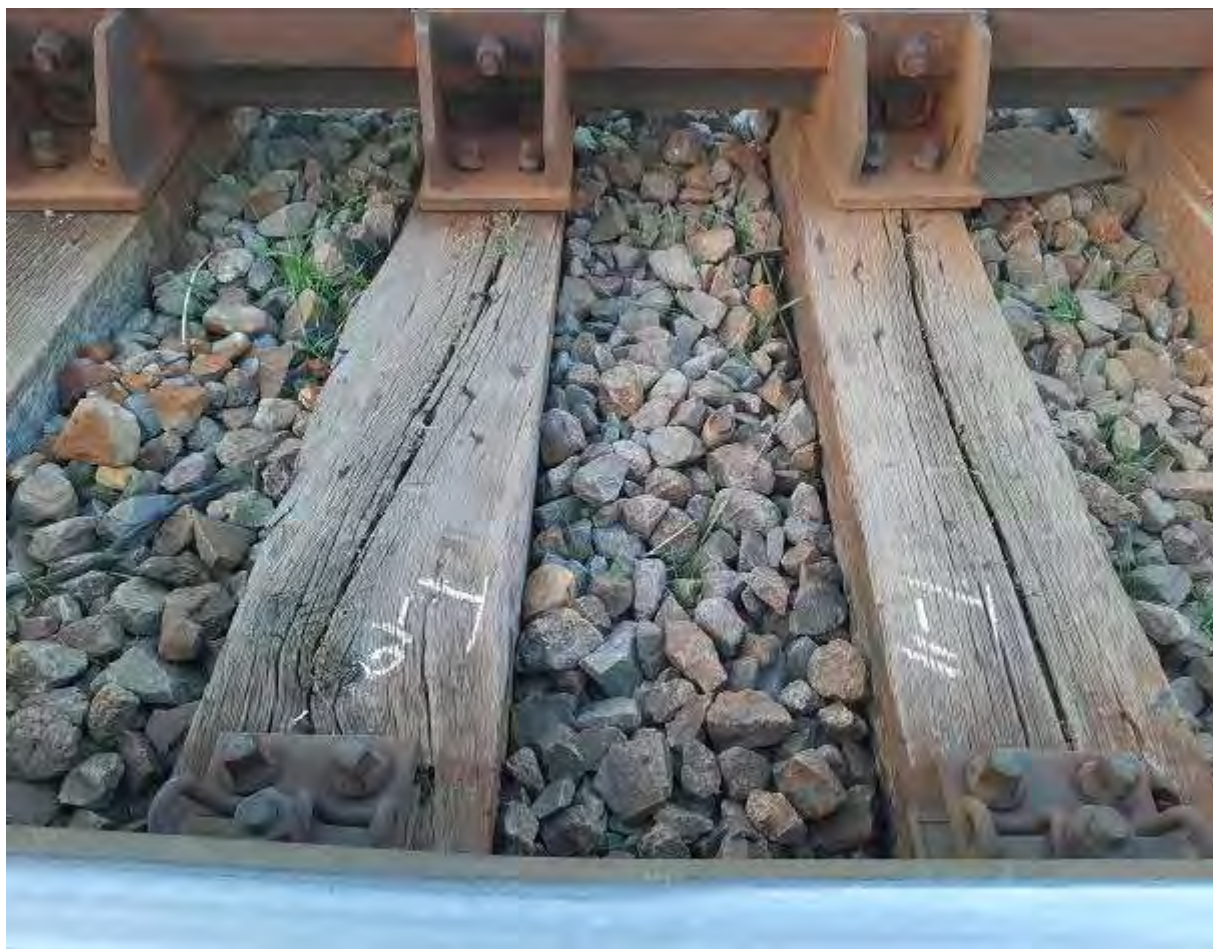
Foto. nr.18– Crăpături longitudinale la traversele nr. -10 și -11
