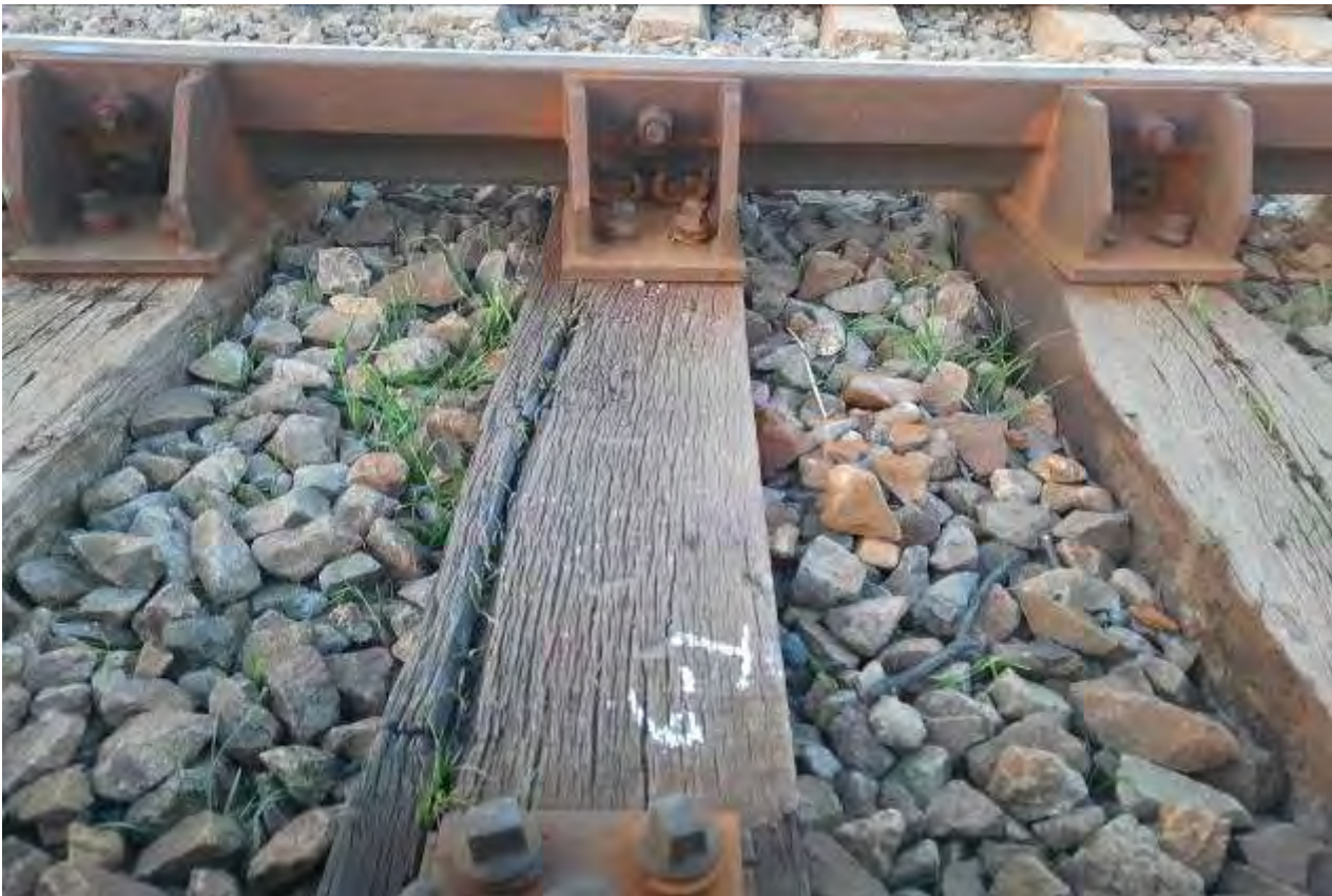
Foto. nr.19– Crăpătură longitudinală cu vegetație în cuprinsul ei la traversa nr. –9
