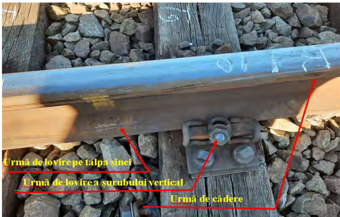
Foto nr.14 – Punctul „B”: a doua urmă de cădere de pe flancul inactiv al ciupercii șinei pe talpa șinei
