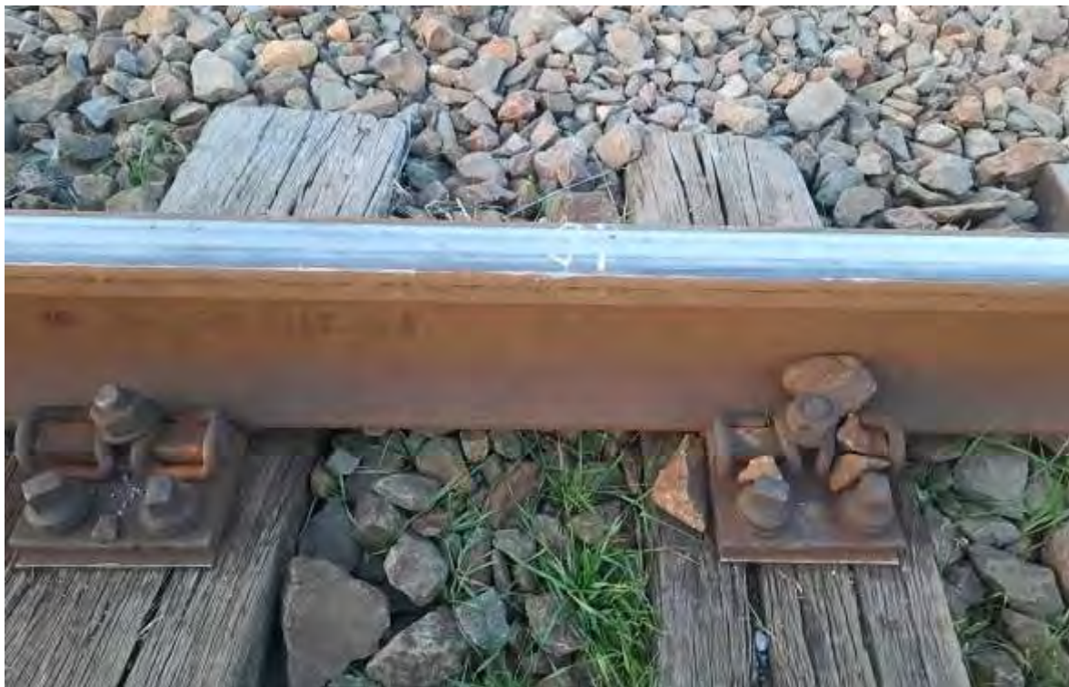
Foto. nr.16 – Punctul „D”: urmă de cădere de pe flancul activ al suprafeței de rulare a șinei de legătură
