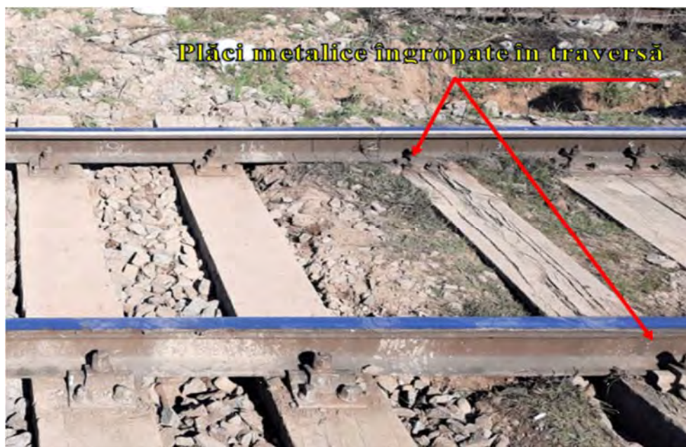
Foto nr. 1: Starea traverselor și a prisme de piatră spartă din vecinătatea punctului „0”
