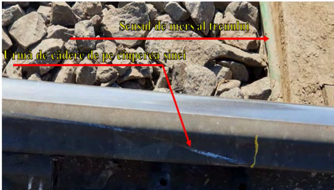
Foto nr. 4: Urmă de cădere de pe ciuperca șinei firului exterior al curbei
