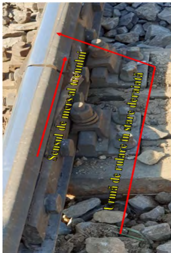
Foto nr.3: Urmă de rulare pe ciuperca șinei firului exterior al curbei
