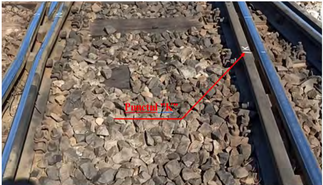
Foto nr.16, punctul „K”: urmă de escaladare a șinei cot din partea stângă a inimii simple a bretelei dintre schimbătorul de cale nr.21 și schimbătorul de cale nr.17
