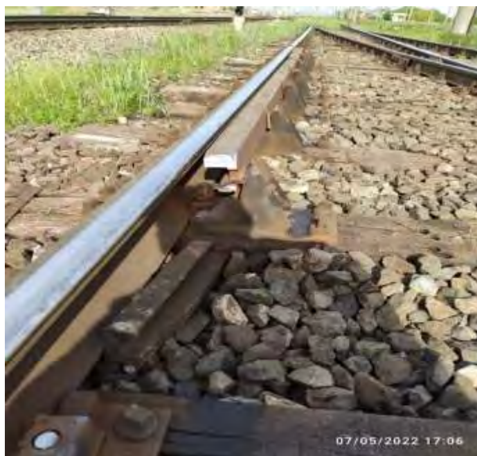
Foto nr.3 - contrașina de pe linia directă ruptă și suportii aferenți deteriorați
