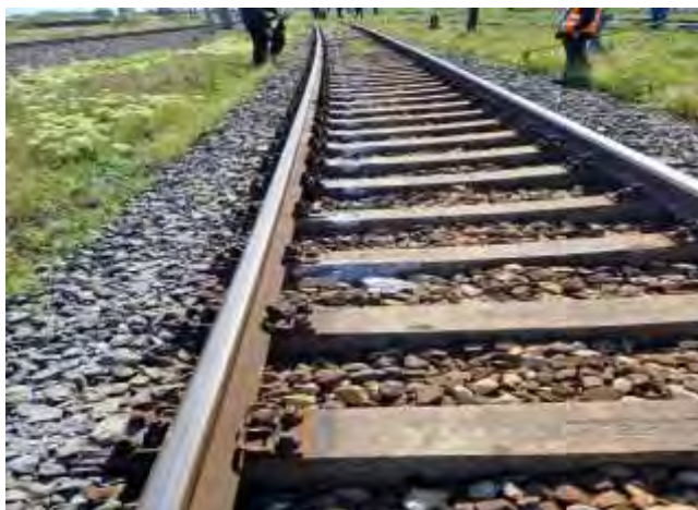
Foto. nr.2 – zona afectată pe linia IV
