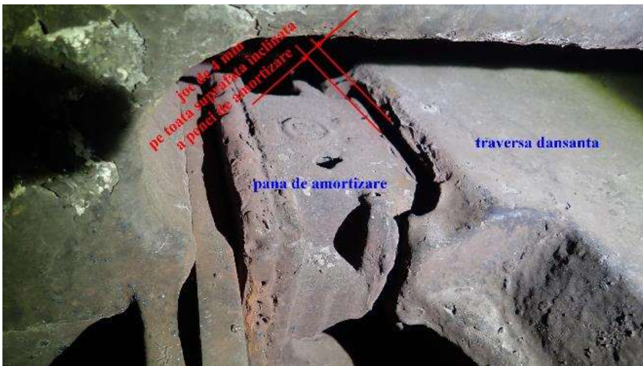
Fig. nr.8, amortizor cu fricțiune constatată cu joc între suprafețele de lucru
