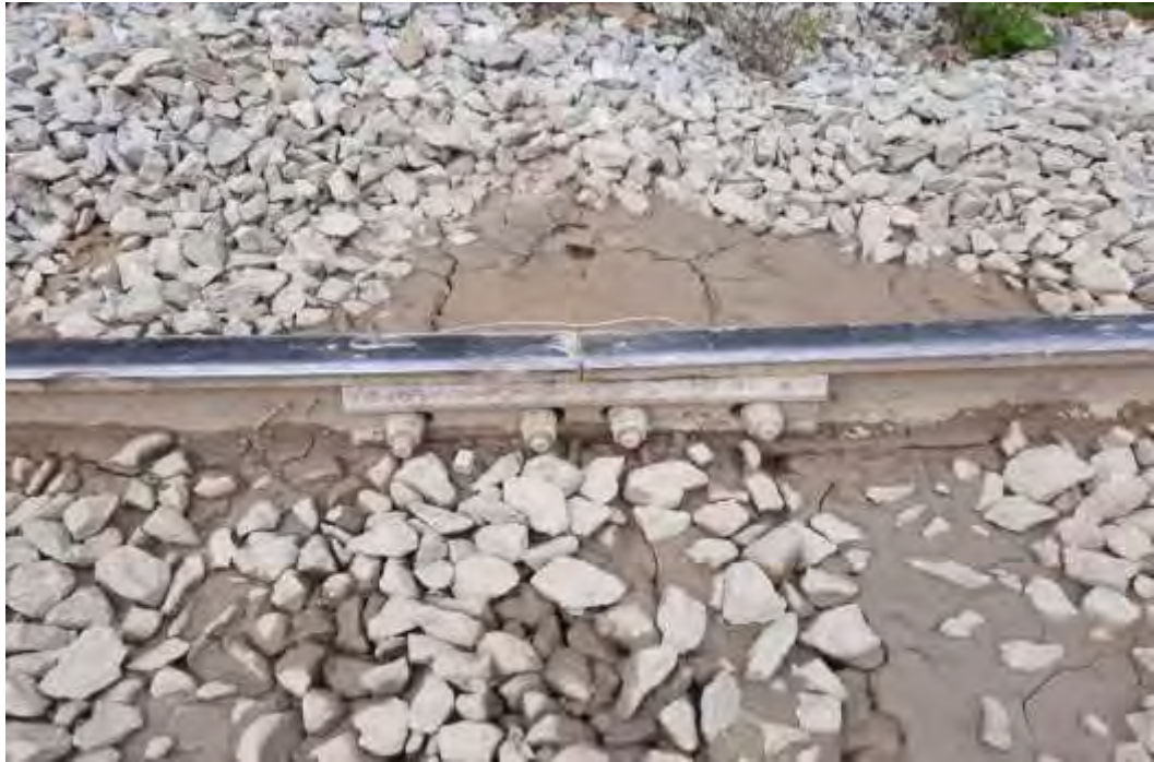
Imaginea nr.10 – joanta mecanică de la km 37+659 de pe firul interior al curbei
