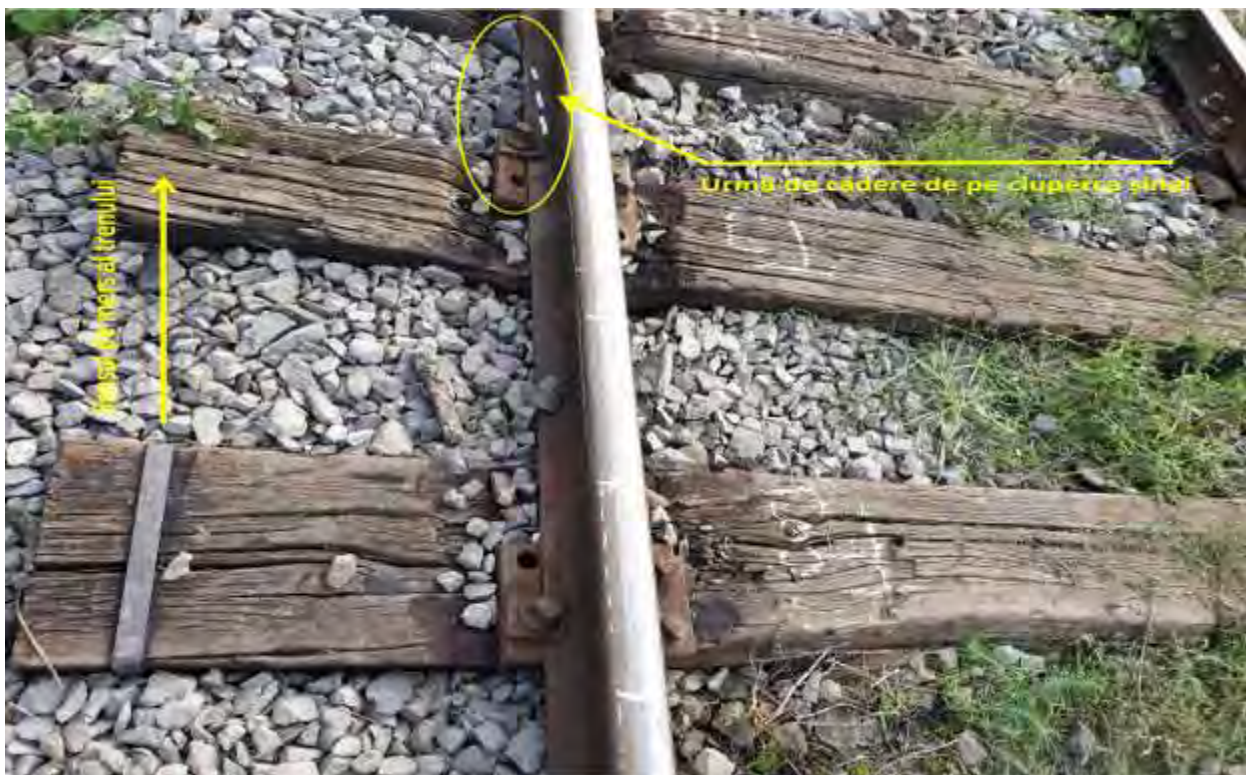
Foto nr.4 - Urmă de cădere de pe ciuperca șinei firului exterior al curbei
