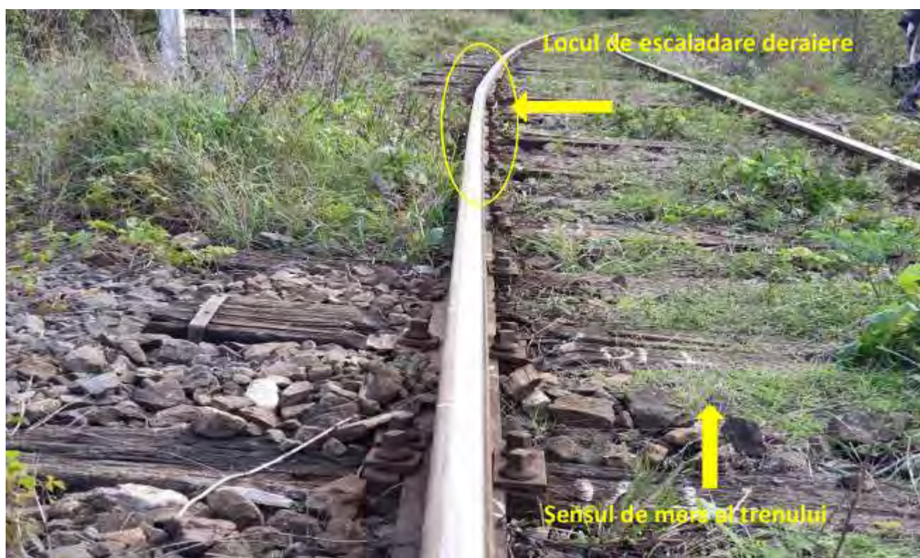
Foto nr.5 – zona unde s-a produs accidentul
