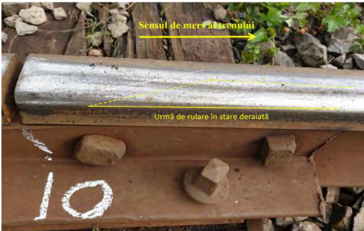
Foto nr.1 -Urmă de rulare pe ciuperca șinei firului exterior al curbei
