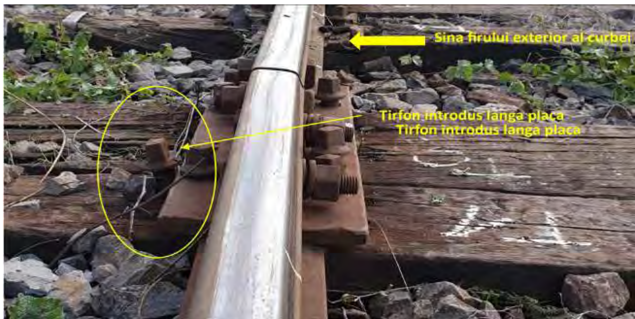
Foto.nr.11 - șina firului exterior - tirfon introdus lângă placă în vederea consolidării prinderii)
