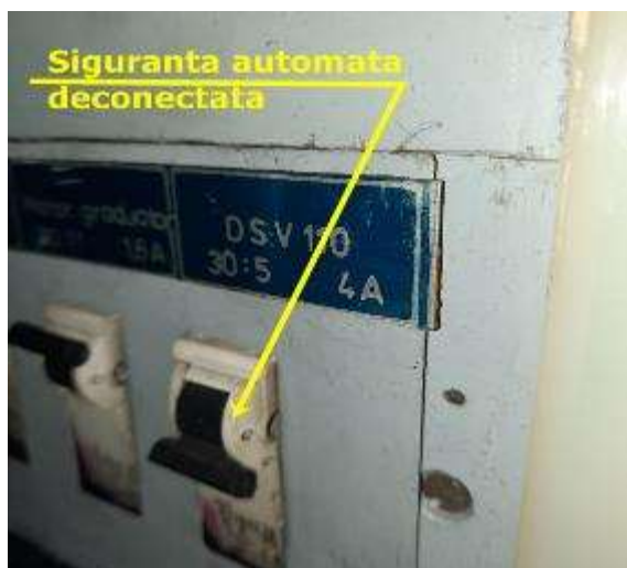
Foto nr.4 Siguranță automată DSV
