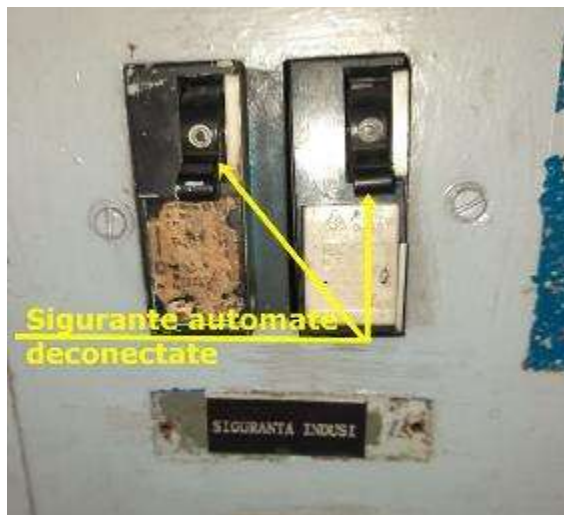
Foto nr.5 Siguranțe automate INDUSI
