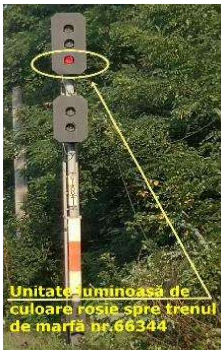
Foto nr.1 Semnalul luminos de ramificație YRT din halta de mișcare Gura Motrului
