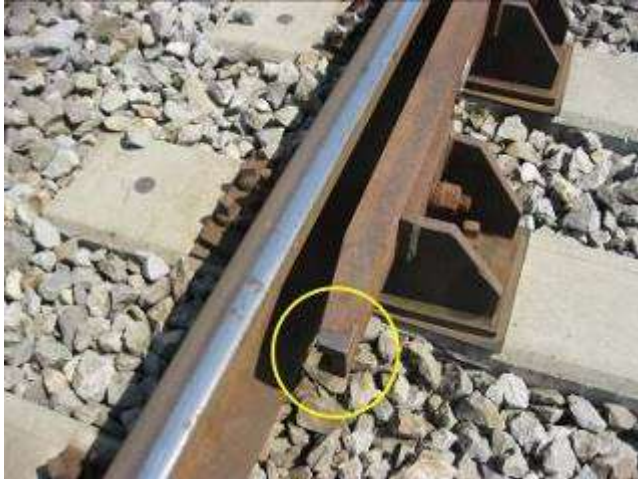
Foto nr.16 – contrașina lovită
