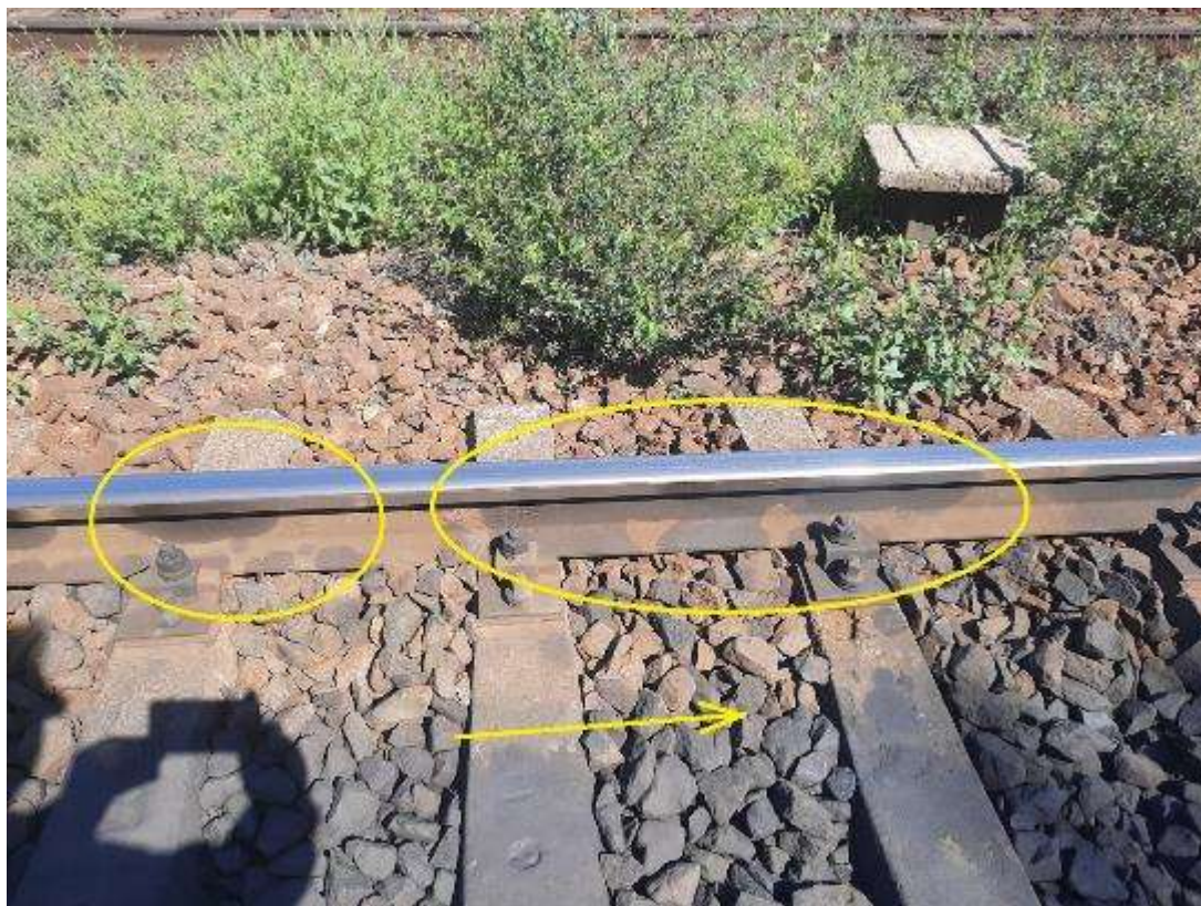
Foto nr.1. Pete de ulei pe șine la linia II directă
