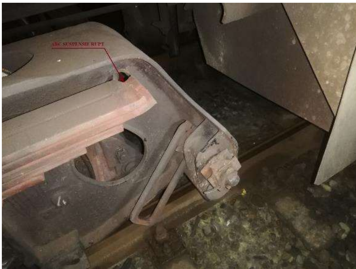
Imaginea 6 – Vagonul nr.33535304637-8 – arc suspensie rupt
